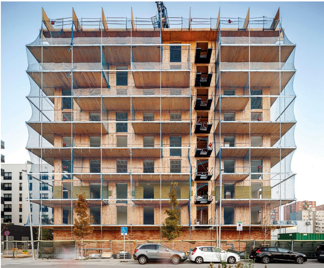
Terrazas para la vida, Edificio de viviendas, Barcelona, 2024. Autores: Daniel Ibáñez y Vicente Guallart. Urbanitree. Foto: © Adrià Goula.
